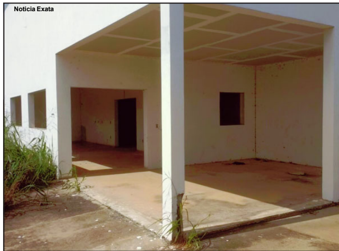
Obra iniciada há muitos anos está abandonada
