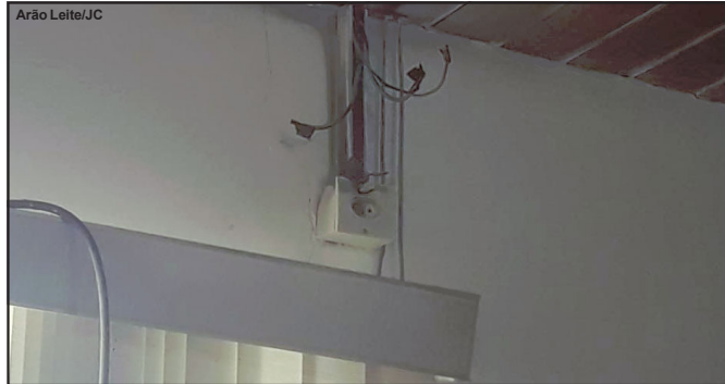
Local onde aconteceu o princípio de incêndio teve fiação isolada
