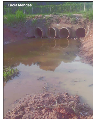
Problema do vazamento foi resolvido na tarde de ontem
