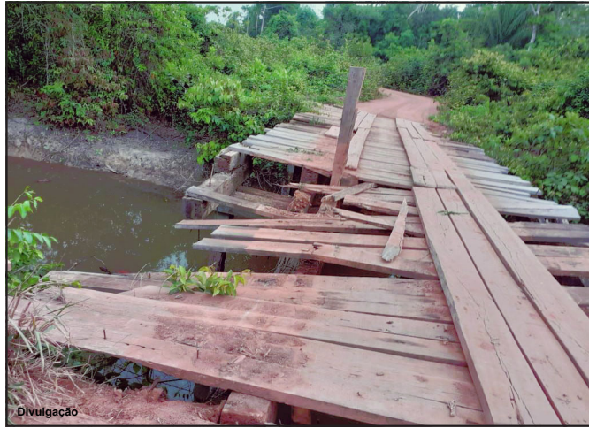
Estrutura que já era precária não suportou mais o tráfego na 4ª Sul
