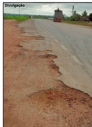
Situação atual do trecho na Rodovia MT-208 entre Carlinda e Alta Floresta
