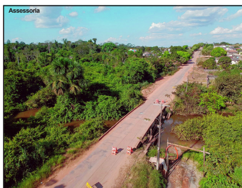
Estrutura sobre córrego Severo foi interditada em AF
