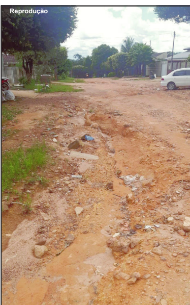
Ruas sem pavimentar estão cortadas ao meio devido enxurradas
