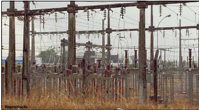
Estrutura atingida por incêndio em Colíder
