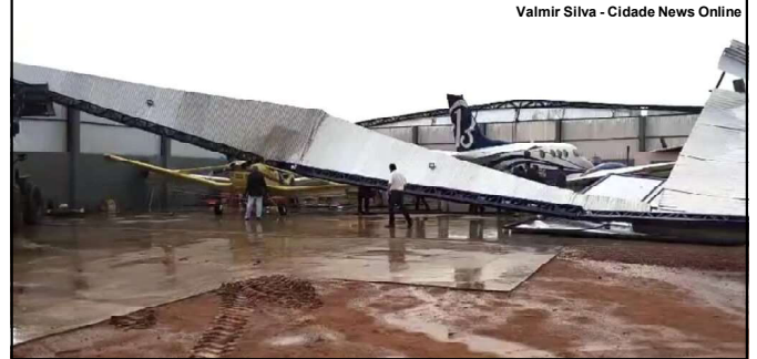
Hangar atingido por temporal em Marcelândia
